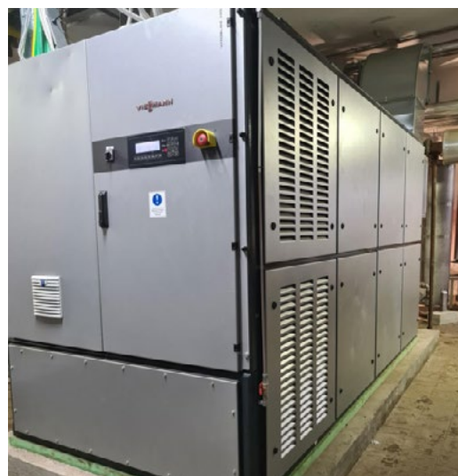
Figura 1: Il nuovo cogeneratore.
