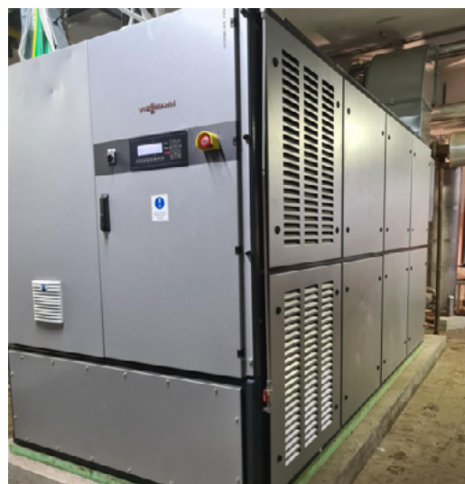
Figura 1: Il nuovo cogeneratore.
