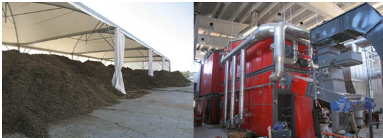
Figura 2 - Area di stoccaggio ed essiccazione cippato e caldaia a recupero dell'impianto Fiusis di Calimera (LE)
