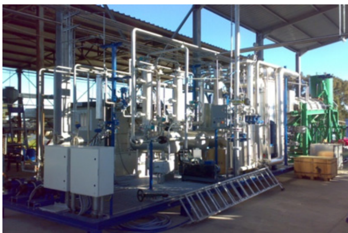
Fig. 2 - Impianti prototipali ENEA di gassificazione: il pretrattamento idrotermico
