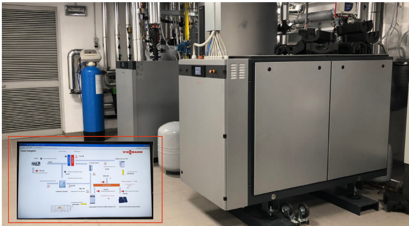
Centrale termica Viessmann della sede di Verona
