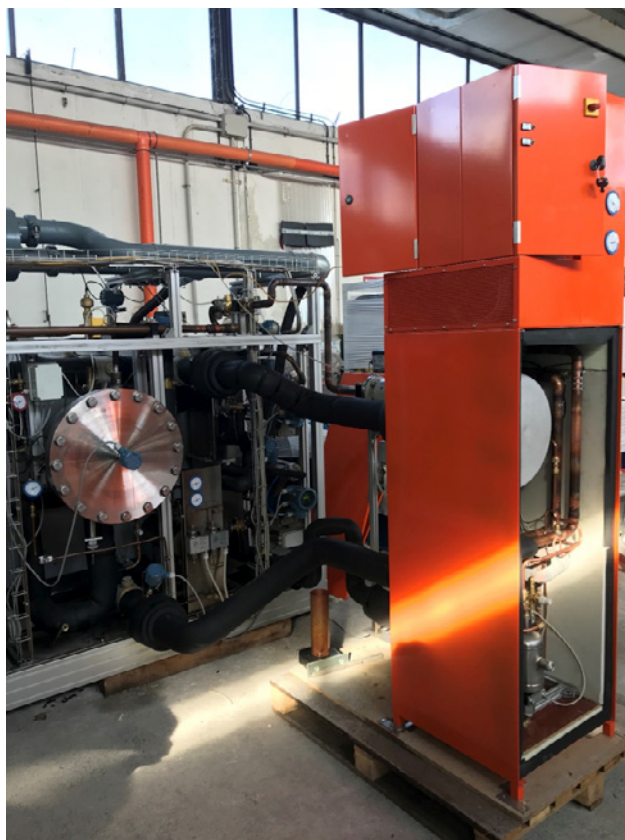
Figure 1 Kit Cold Energy collegato a banco test rappresentativo del reale collegamento che verrà effettuato sul campo durante il "revamping" di un impianto frigorifero esistente.
